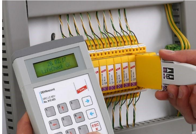
Imagem 2. Através de equipamentos adequados é possível verificar o estado dos Dispositivos de Proteção contra Surtos (DPS).
