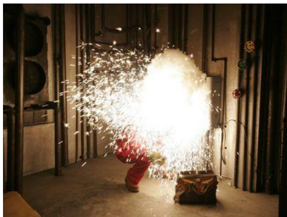
Imagem 1. Ocorrência de um arco elétrico em um painel de baixa tensão
