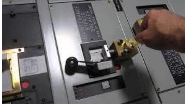
Imagem 7. Sistema de intertravamento Kirk Key Interlock™ 3
