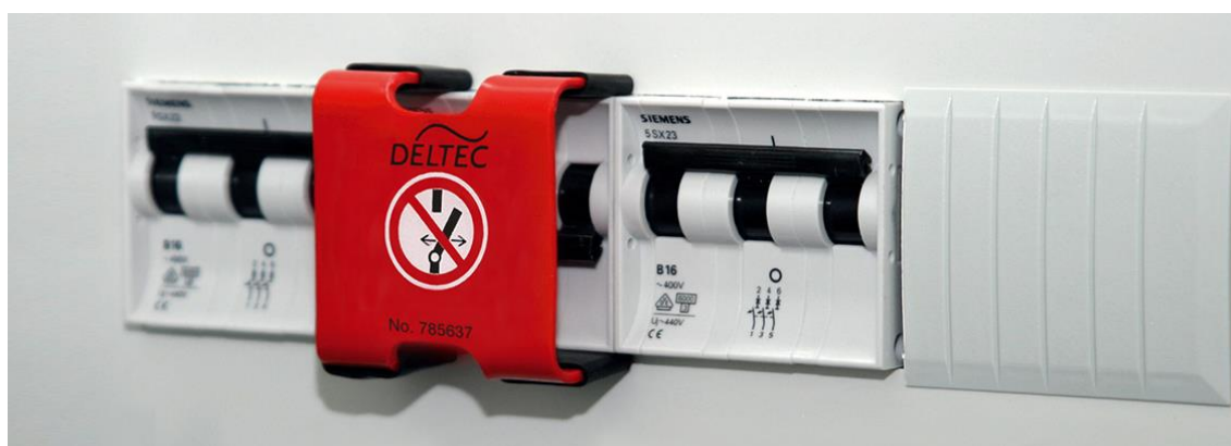
Imagem1. Sistema bloqueio impedindo a ligação de um disjuntor.
